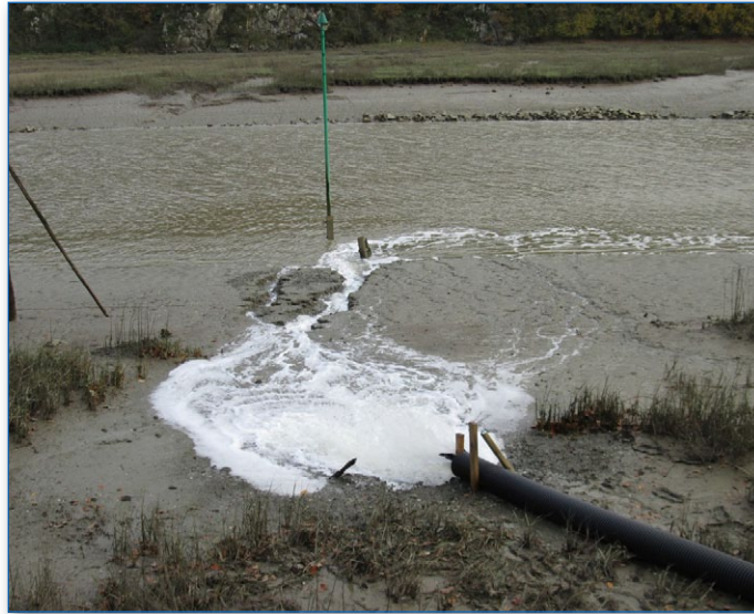
Le rejet d'eau après décantation
